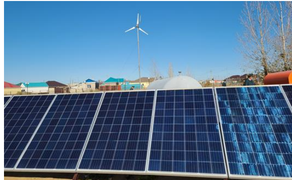
草の根資金で供与した太陽光・風力発電設備
