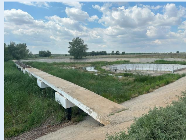
サズドゥ貯水池の排水設備の一部
