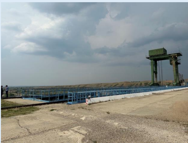
水門とゲートを開閉するクレーン
