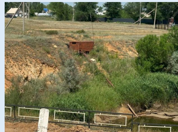
灌漑用ポンプ
