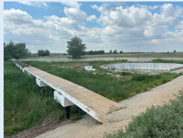
Часть дренажной системы водохранилища
